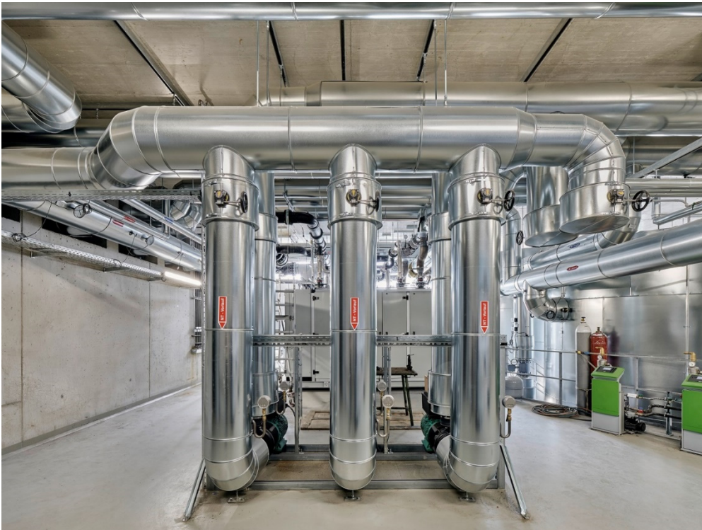
Bild 53 Verrohrung in der Energiezentrale mit Wärmepumpen im Hintergrund (© Zooley Braun)
