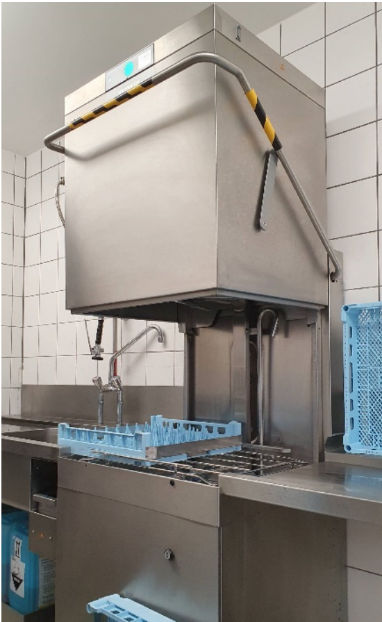
Bild 37 Neue Geschirrspülmaschine im Willy-Körner-Haus
