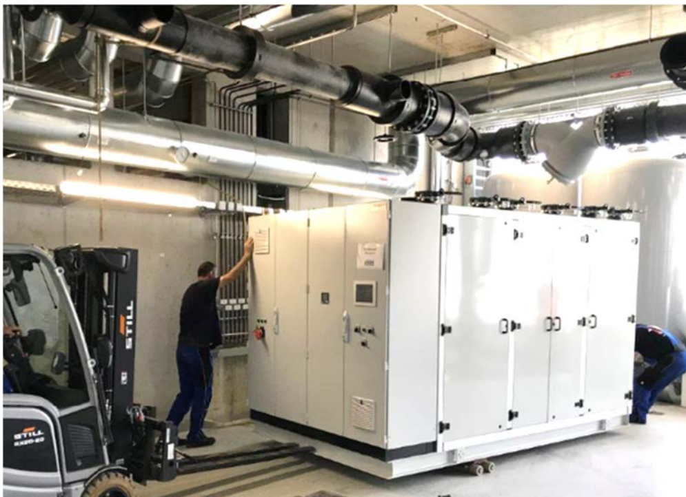
Bild 52 Aufstellung der Wärmepumpen innerhalb der Energiezentrale
