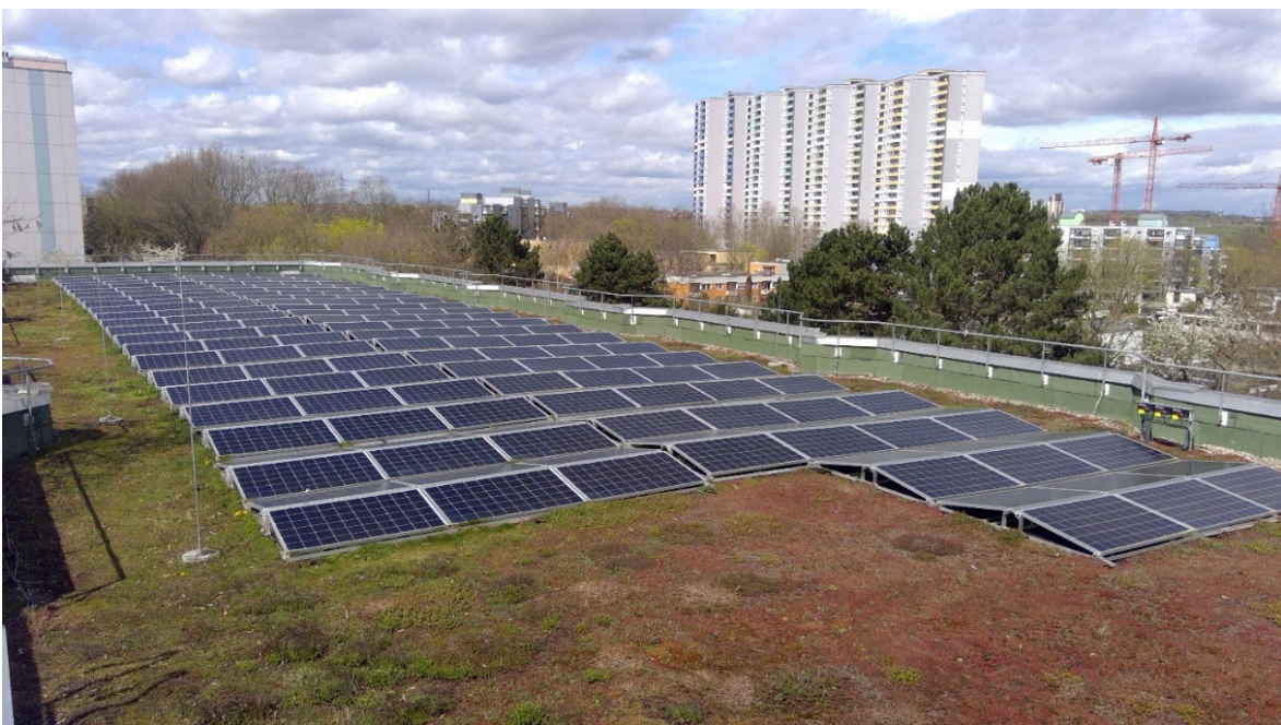
Bild 36 Photovoltaikanlage auf dem Gebäude Eschbach-Gymnasium
