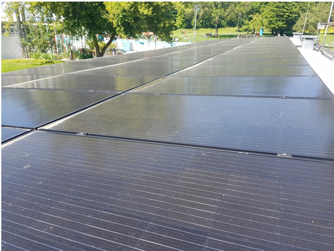
Bild 30 Hybridkollektoren (PVT) der Pilotanlage
