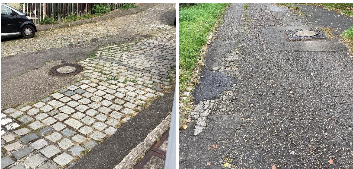
Abbildung 13: Schäden an der Oberfläche
