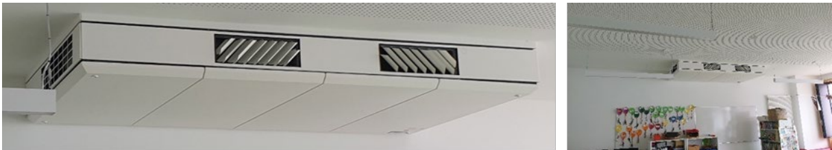
Bild 6-54: Dezentrales Lüftungsgerät und Montageort im Klassenraum (Filderschule)
