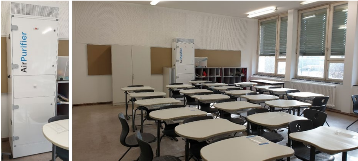
Bild 6-19: Luftreinigungsgerät und Aufstellort im Klassenraum der Wilhelmsschule Wangen
