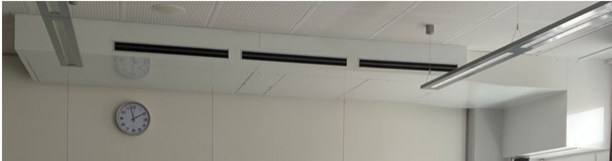
Bild 6-2: RLT-Anlage und Montageort des Solitude-Gymnasiums
