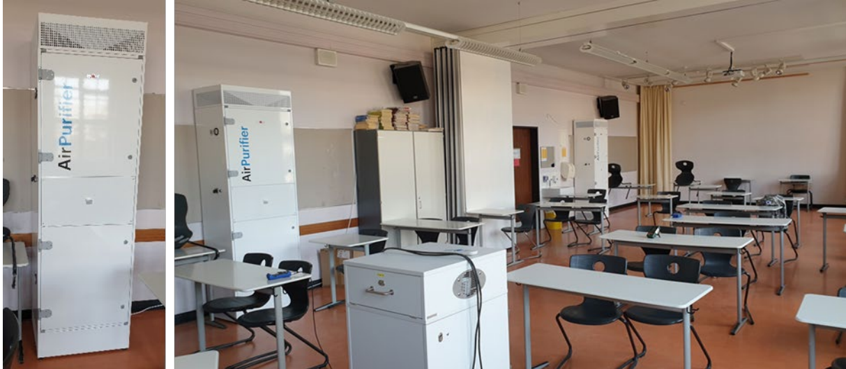
Bild 6-44: Luftreinigungsgerät (links) und Aufstellort (rechts) im Klausurraum des Zeppelin Gymnasiums
